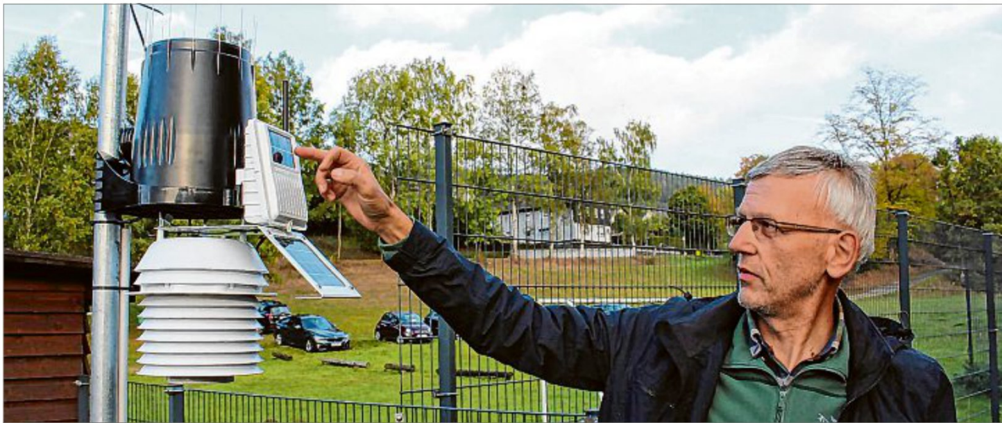
Meinolf Pape erläuterte gestern die Technik der Wetterstation, die ab sofort am Hesselbacher Freibad installiert und damit Teil des Netzwerkes wetter-sauerland.de ist. Foto: abbl
