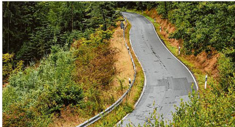
Die Kreisstraße 36 „schlängelt“ sich beinahe malerisch durch den Wald von Hesselbach nach Bad Laasphe, weist aber einen Sanierungsstau von einer Mill. Euro auf. Der Kreis selbst bewertet die Straße mit einer „4-“.
